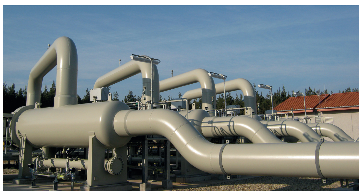
Beispiel einer Filteranlage
